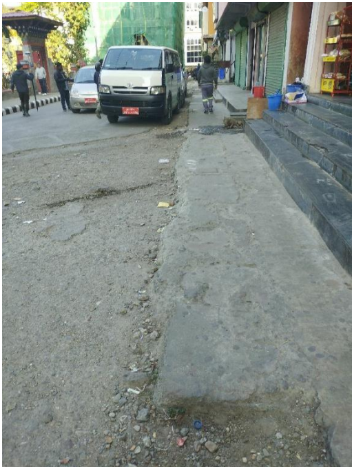
Blocked Drain above Zangdopelri
